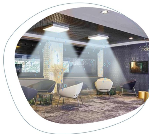
Luminaires LiFi installés dans un espace de coworking
